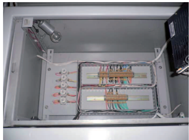
Foto 2 – Painel de Entrada (Interno)
