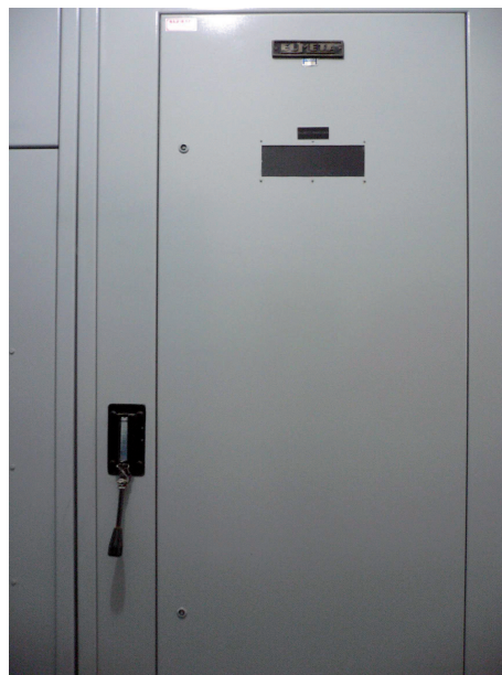
Foto 5 – Painel da Chave Seccionadora (Externo)
